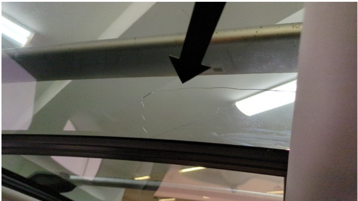
Tak Glastak Skada Det finns ingen skadeanmälan 15 000 kr
