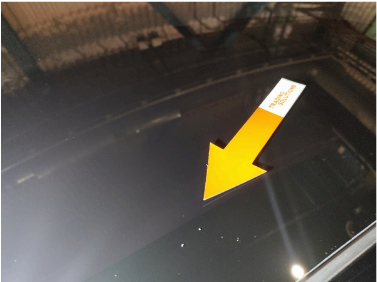
Tak Glastak Övrigt Stenskott
