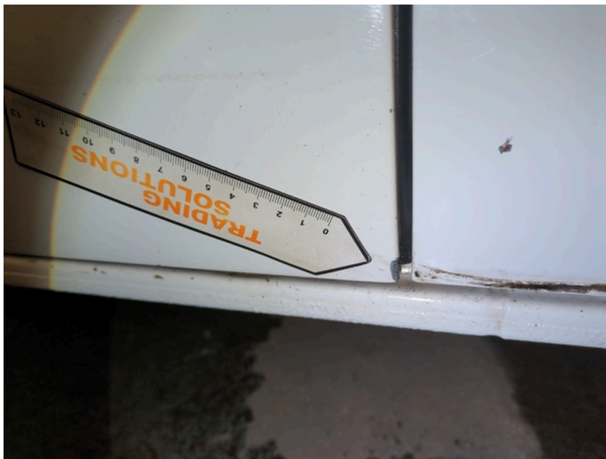
Dörr Höger skjutdörr Lackskador
