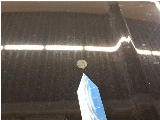
Damage 13: Roof: Roof (Vogelkotverätzung) - Paint defect - Paint
