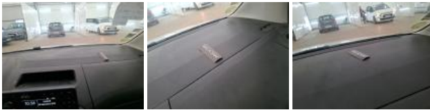
Garniture intérieur, Cassé, E - Remplacer
