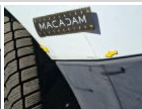
Panneau ARD, Mauvaise réparation, Peindre
