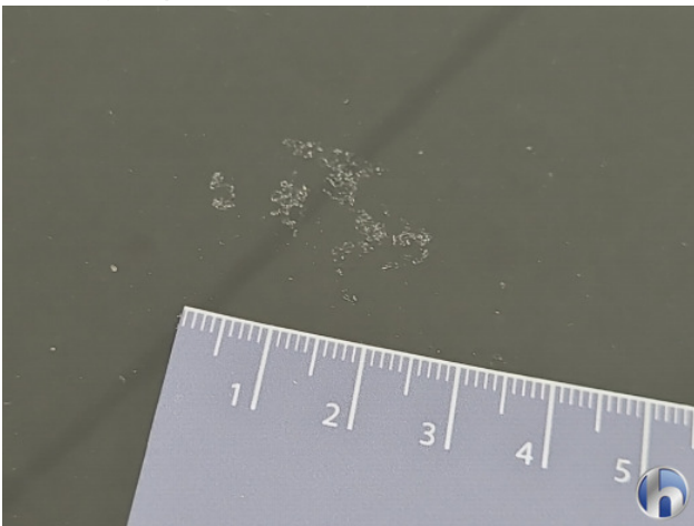
6. Ingebrande vogelpoep Beschadigd - Spuiten
