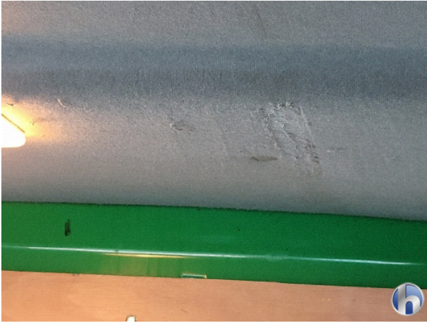
1. meerdere interieur schade Beschadigd - Vernieuwen
