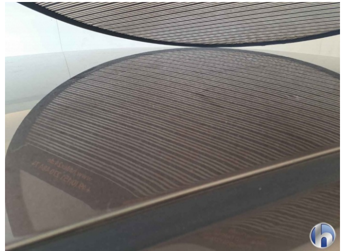
29. Dach mit 60 Dellen à 20-25mm
