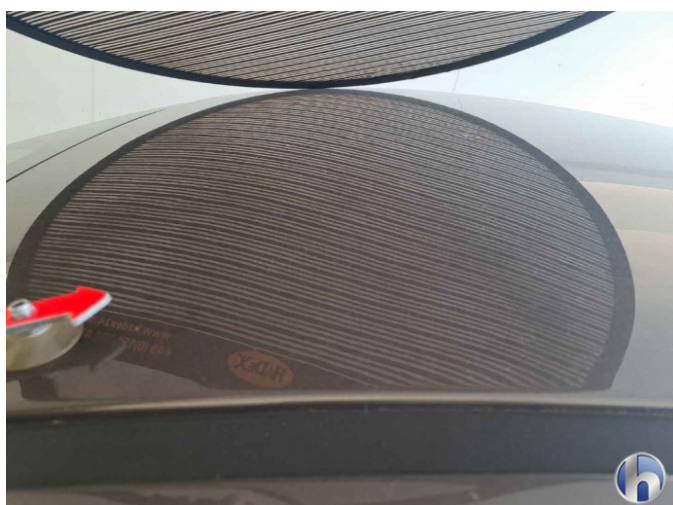
29. Dach mit 60 Dellen à 20-25mm
