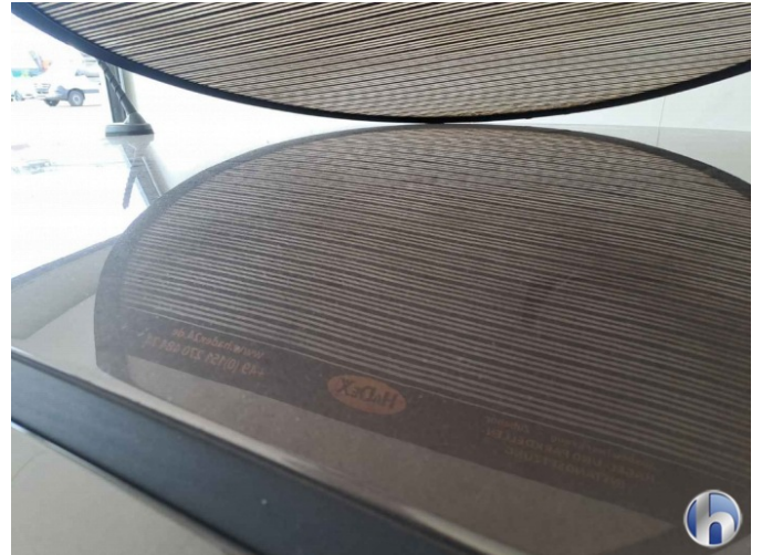
29. Dach mit 60 Dellen à 20-25mm
