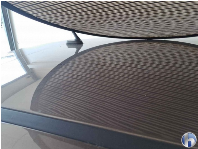
29. Dach mit 60 Dellen à 20-25mm
