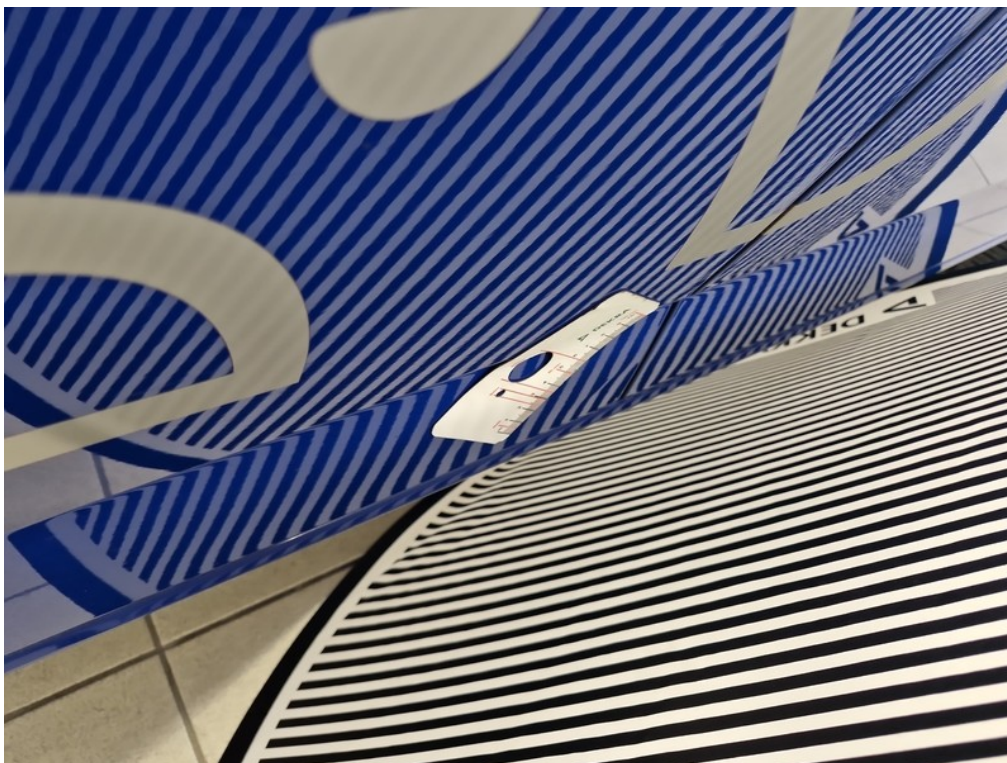
Viz popis k poškození č. 15
