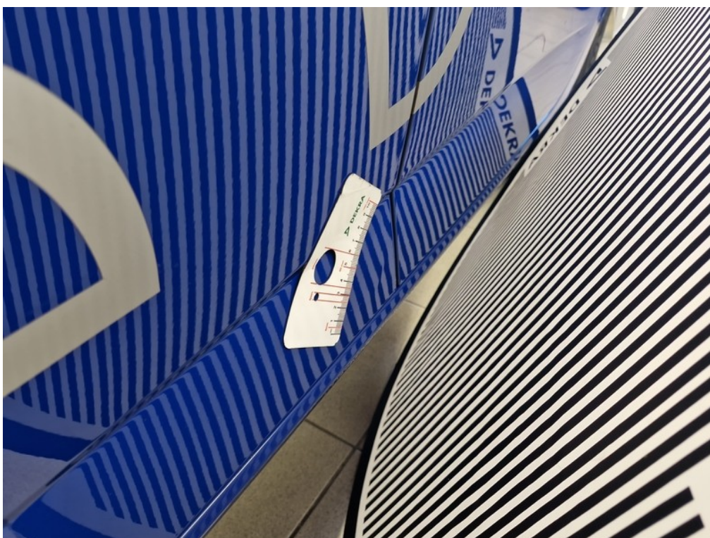
Viz popis k poškození č. 15
