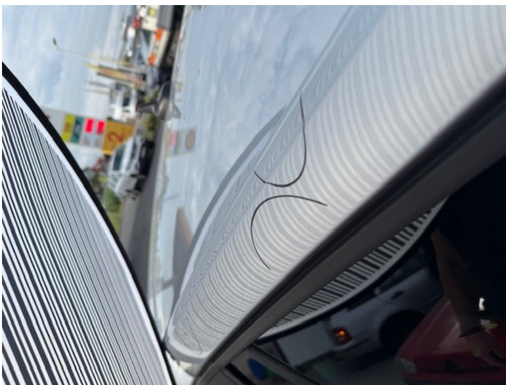
Viz popis k poškození č. 18
