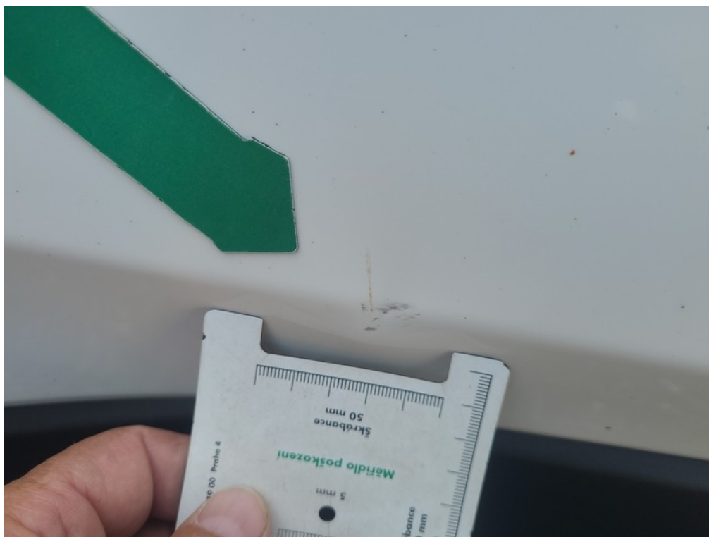
Viz popis k poškození č. 5
