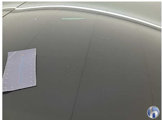
4. Dak Krassen - Aanvaardbaar
