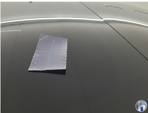
4. Dak Krassen - Aanvaardbaar
