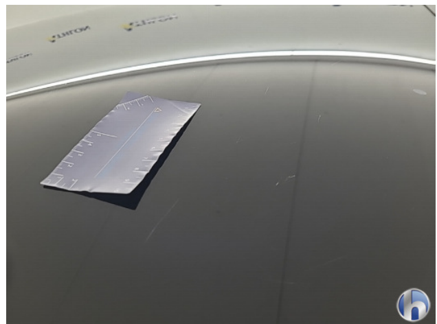
4. Dak Krassen - Aanvaardbaar
